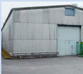
Plaques ondulées amiantées
