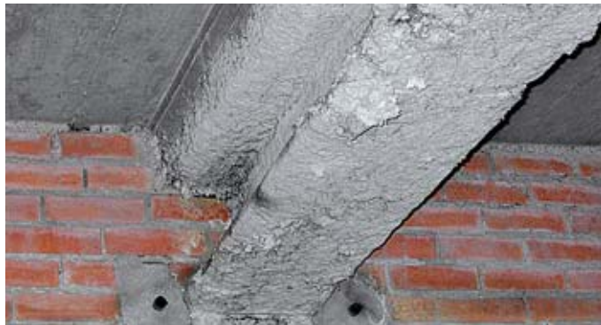
Amiante floqué sur poutre métallique
