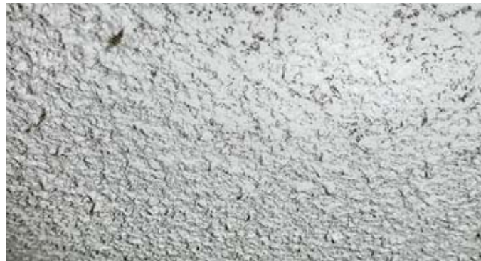
Crépi acoustique amianté
