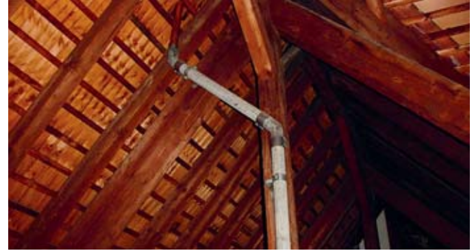
Tuyau d'évacuation d'air
