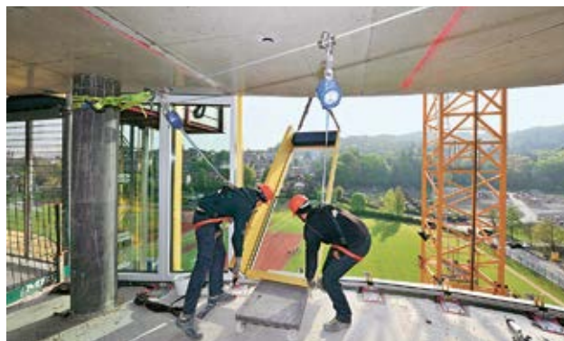
1 En cas de risque de chute, il faut appliquer les mesures de protection appropriées.
