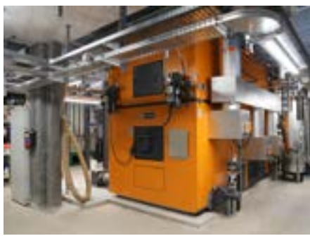
↑ Chaudière à bois : une meilleure efficacité résulte d'une conception et exploitation correctes
