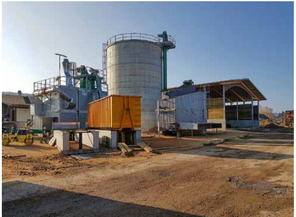
↑ Installation pour la production de pellets avec un container
