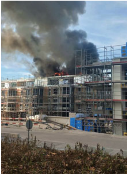
↑ Identifier les risques à un stade précoce afin d'éviter les incendies sur les chantiers, auteur photo police cantonale argovienne. Source : Police cantonale argovienne
