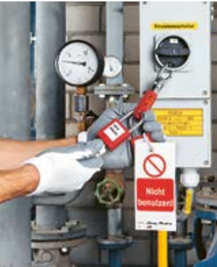
Règle 5 Arrêter et sécuriser les installations.
