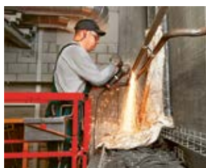
1 Protection des conduites électriques
