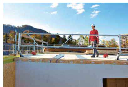
3 Garde-corps mobile pour zone à risque de chute temporaire au bord du toit
