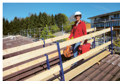
3 Surfaces de toiture non résistantes à la rupture: utiliser des passerelles.
