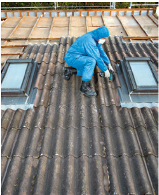
Règle 9 Se protéger contre les fibres d'amiante.
