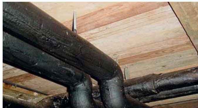
Revêtement bitumeux amianté
