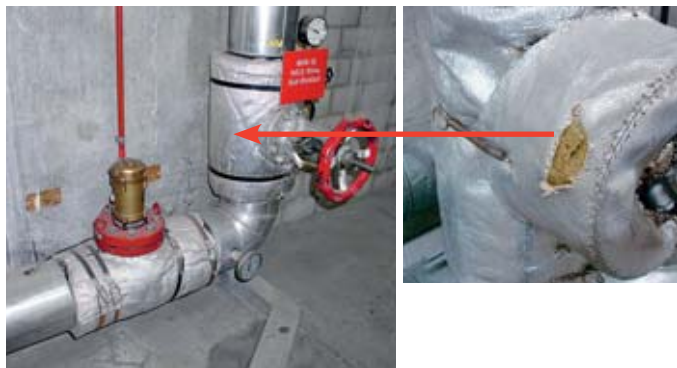
Coquilles d'isolation thermique amiantée
