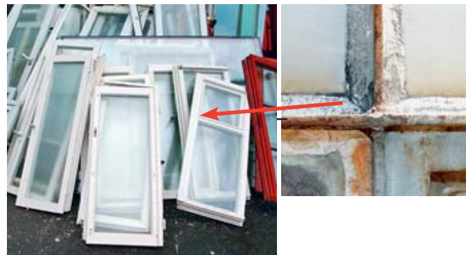
Le mastic de fenêtres comporte de l'amiante fortement aggloméré
