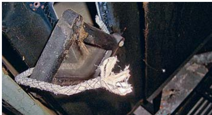
Cordon amianté servant de joint d'étanchéité pour une installation
