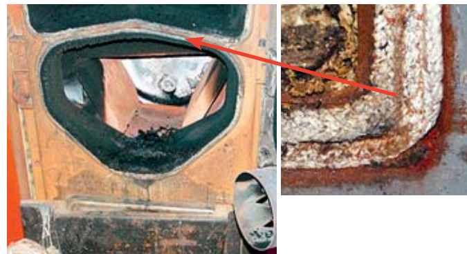
Cordon amianté d'une chaudière
