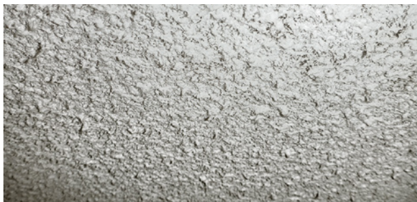
Crépi acoustique amianté
