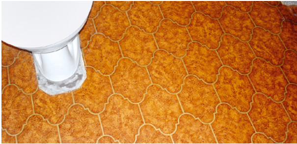
Revêtements de sols multicouches amiantés; cushion vinyl
