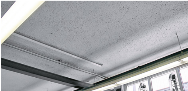
Revêtement d'amiante floqué au plafond
