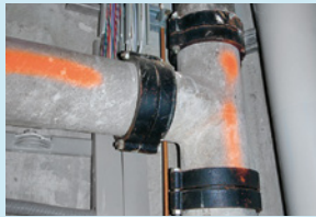
Tuyaux en fibrociment
