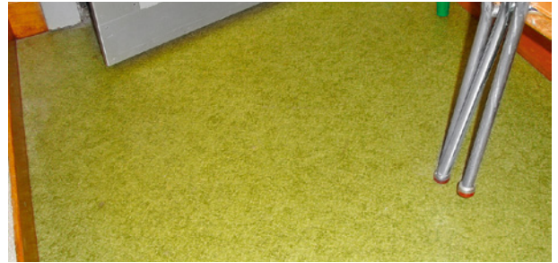
Revêtements de sols multicouches amiantés; cushion vinyl
