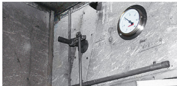
Conduit d'aération avec plaques en fibrociment
