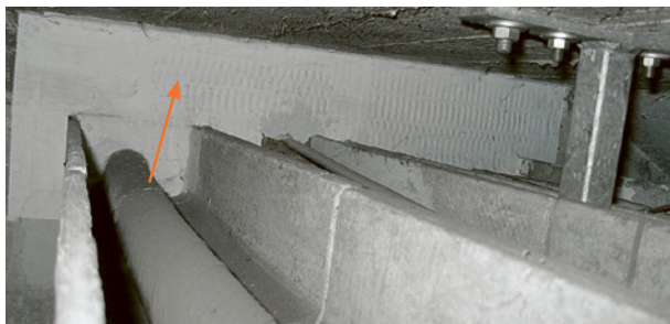
Traversée de câbles avec cloison pare-feu
