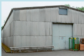
Plaques ondulées amiantées
