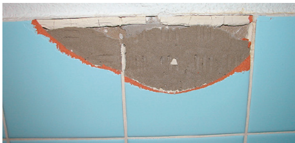
Amiante chrysotile < 1 % dans la colle
