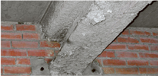
Amiante floqué sur poutre métallique
