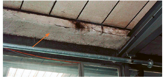
Crépi acoustique amianté
