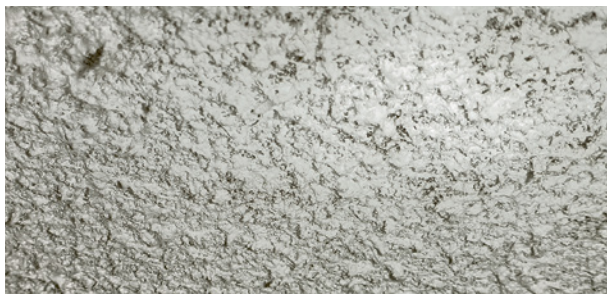
Crépi acoustique amianté
