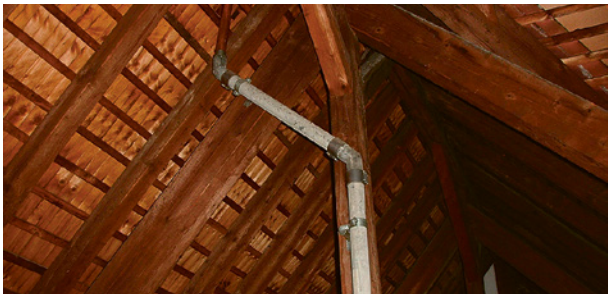
Tuyau d'évacuation d'air
