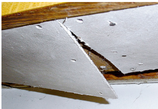
Panneaux légers contenant de l'amiante
